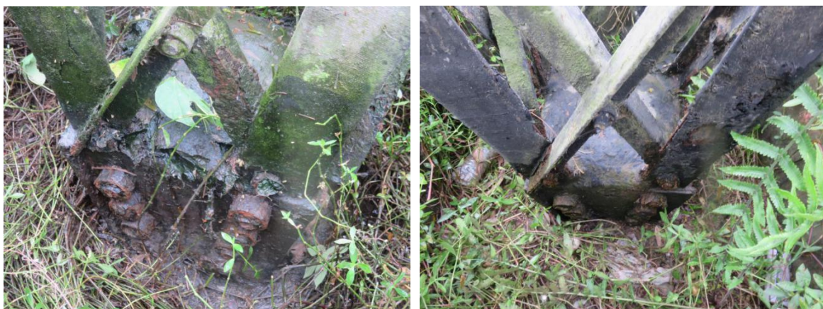
图片 1-1 500kV 洪板一线拉线塔锈蚀情况
