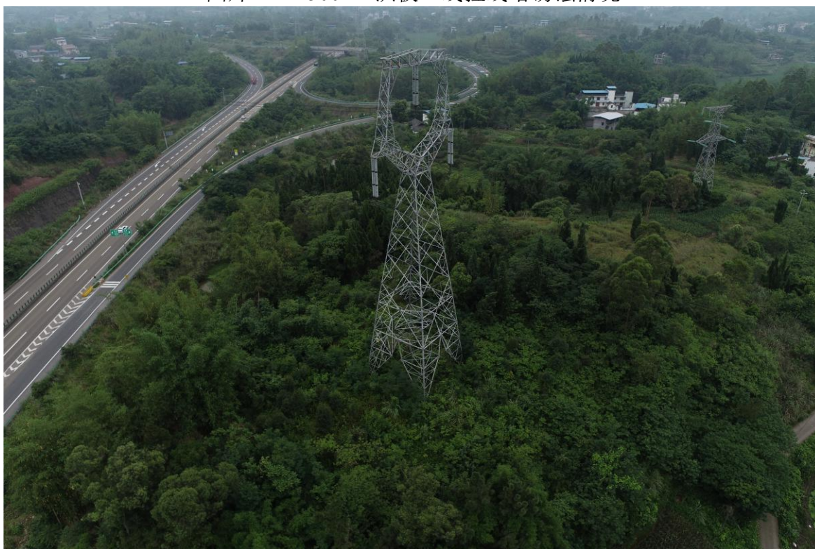
图片 1-3 500kV 洪板一线跨越夏蓉高速处
