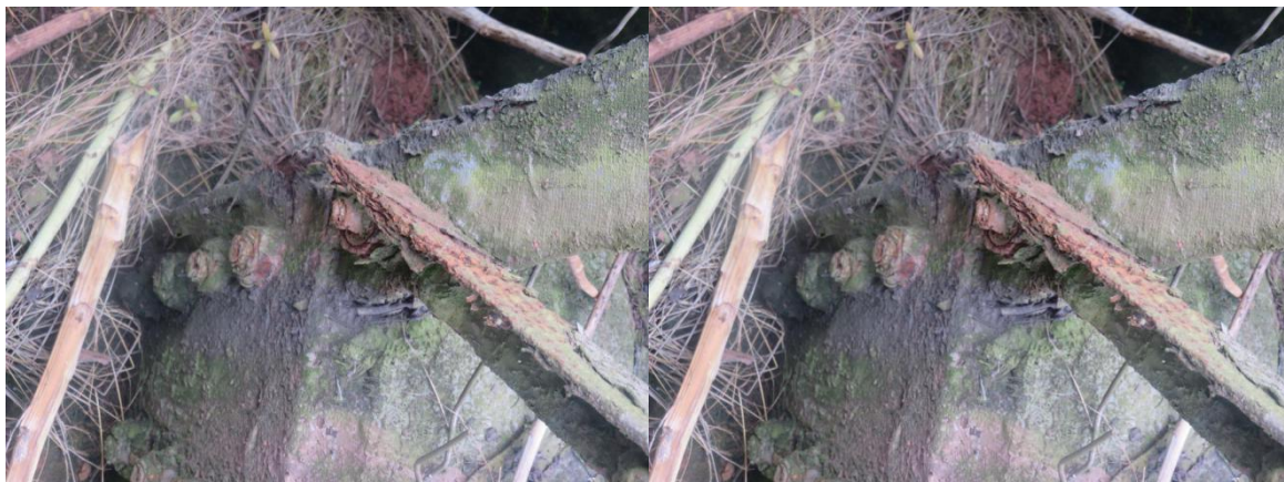
图片 1-2 500kV 洪板二线拉线塔锈蚀情况
