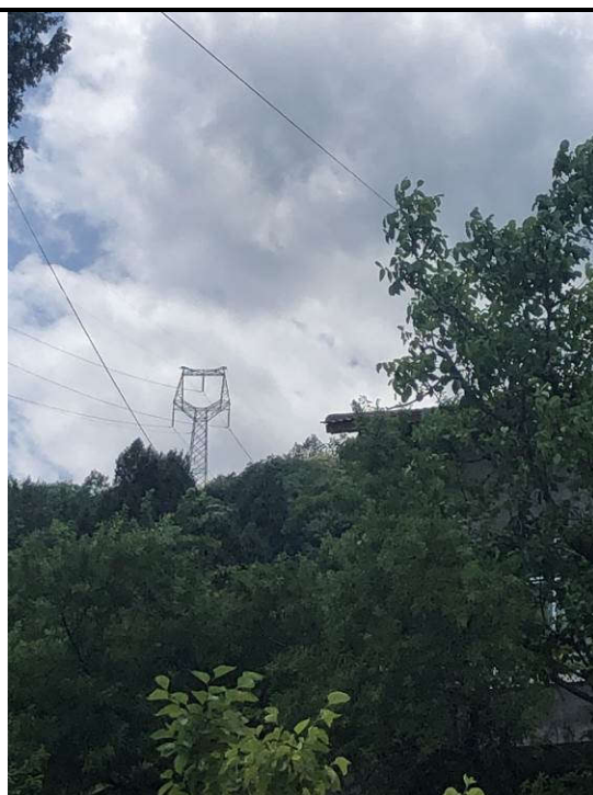
\pi 接点附近（220kV 复兴变侧）
