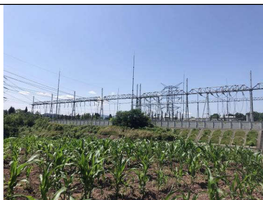
玛瑙 500kV 变电站本期完善间隔侧外环境
