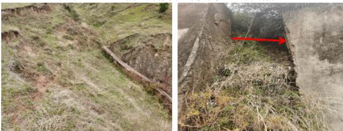
图片 1-3 234#塔位基础位移（滑坡、挡墙位移）
