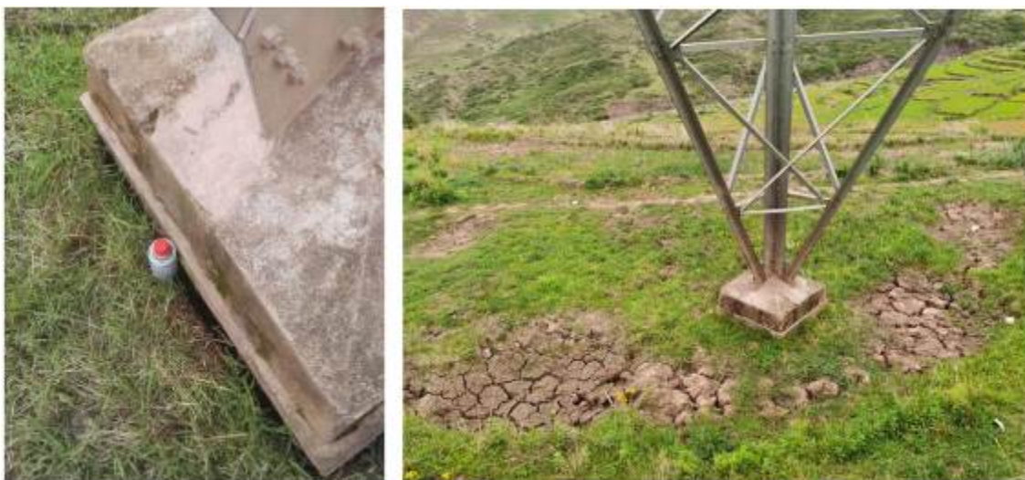
图片 1-1 228#塔位基础沉降
