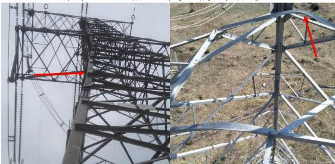
图片 1-4 234#塔位结构变形（角钢弯曲、扭曲）
