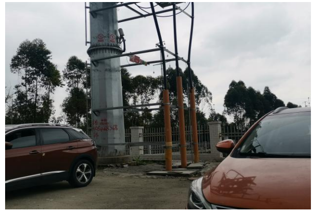
34 号杆塔硬化情况
