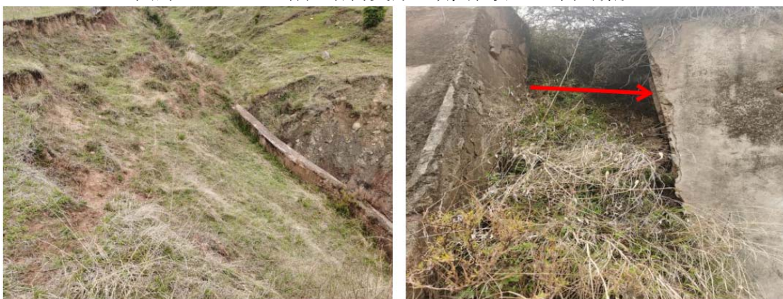
图片 1-3 234#塔位基础位移（滑坡、挡墙位移）
