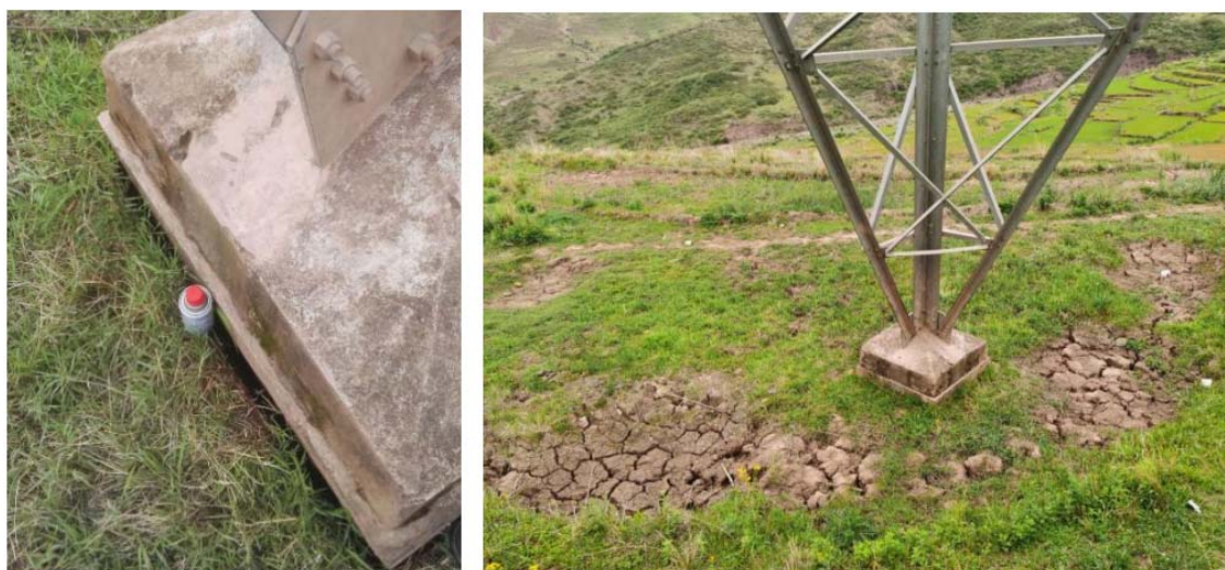
图片 1-1 228#塔位基础沉降
