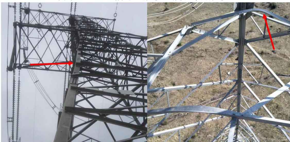
图片 1-4 234#塔位结构变形（角钢弯曲、扭曲）
