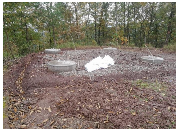
观东 II 线 BN18 塔临时排水沟
