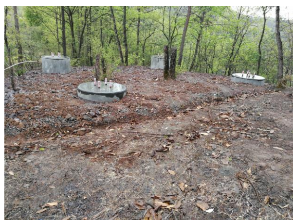
观东 II 线 BN11 塔临时排水沟
