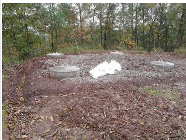
观东 II 线 BN18 塔临时排水沟
