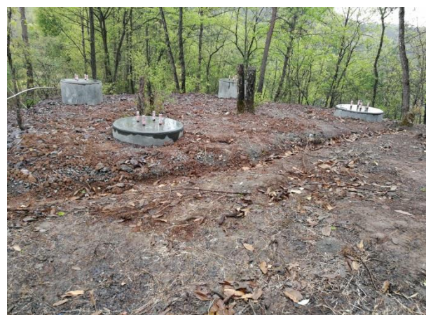
观东 II 线 BN11 塔临时排水沟
