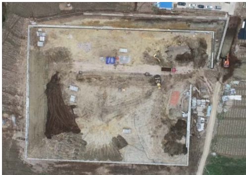
开关站截排水沟
