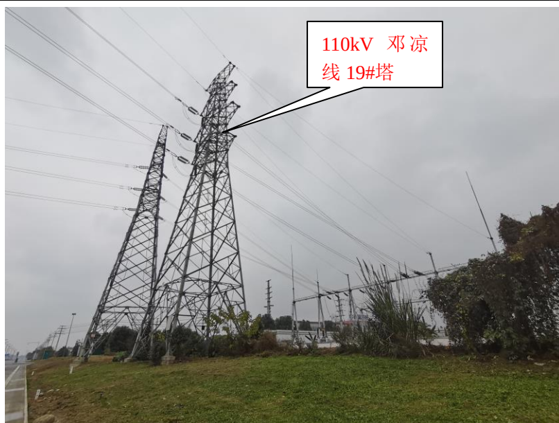
图 3-2 110kV 邓凉线现状
