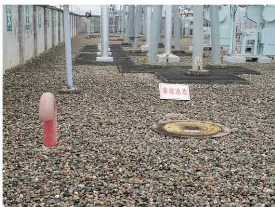
图 3-1 站内事故油池
