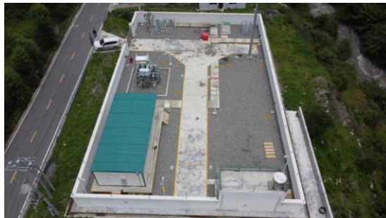
变电站整体防护
