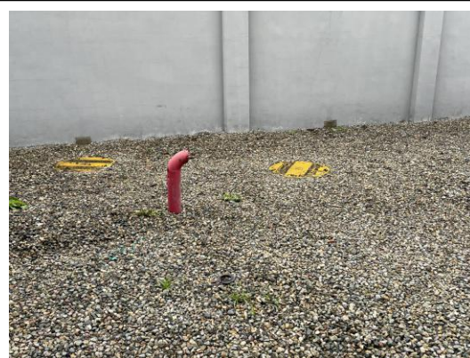
图 26 府青路变电站站内事故油池
