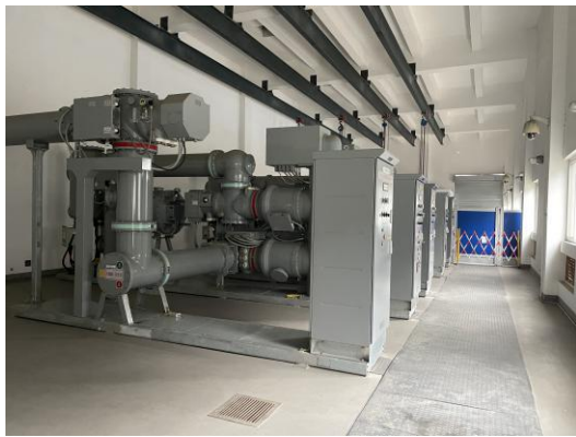
图 21 110kV 配电装置等采用 GIS 户内布置
