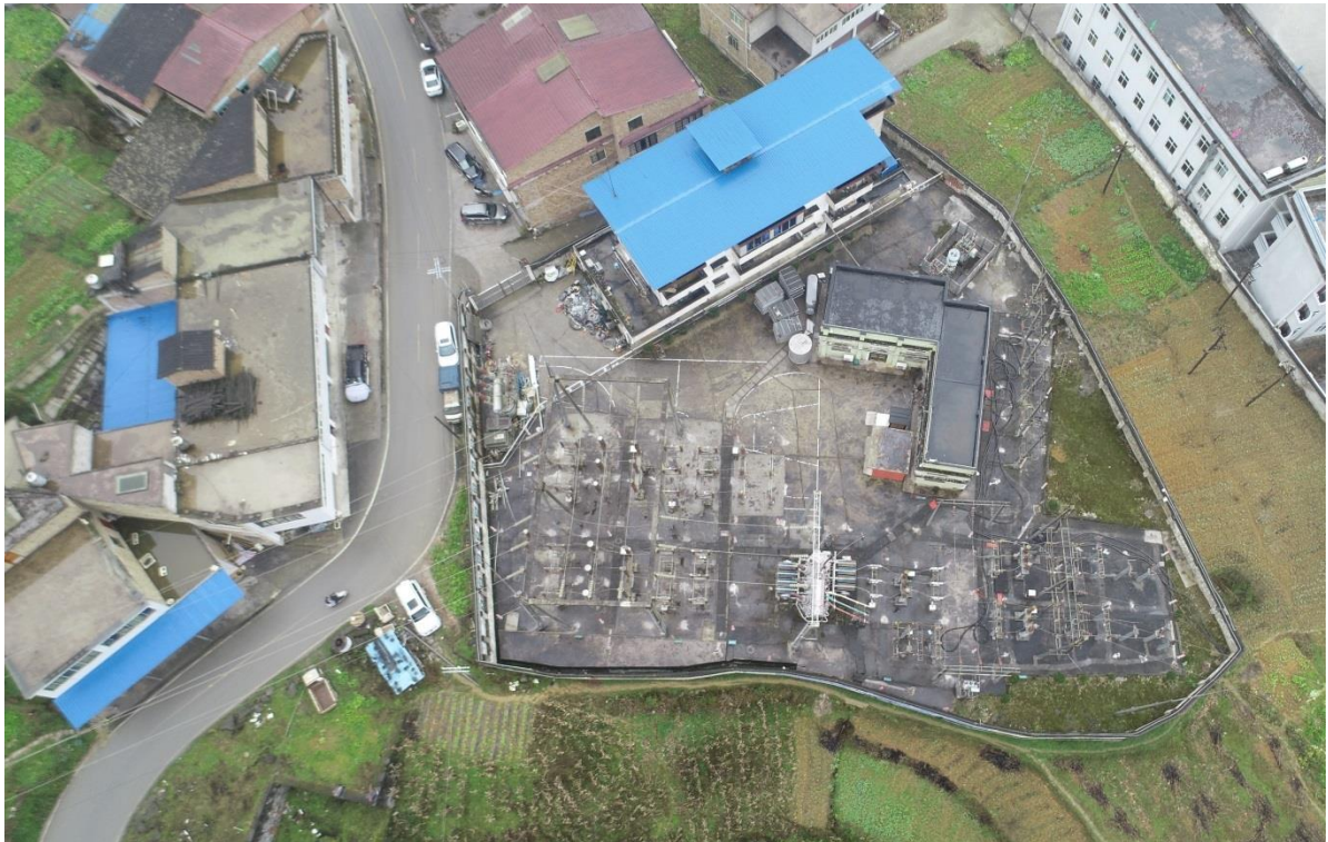
摩尼 110kV 变电站现状
