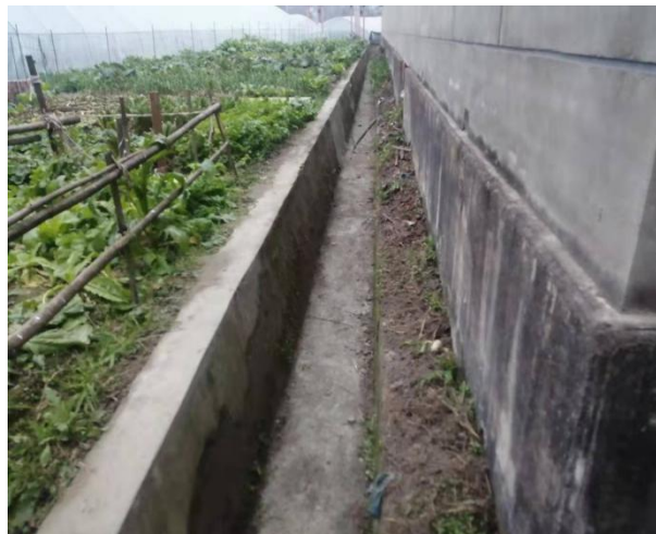
站外排水沟及复耕情况
