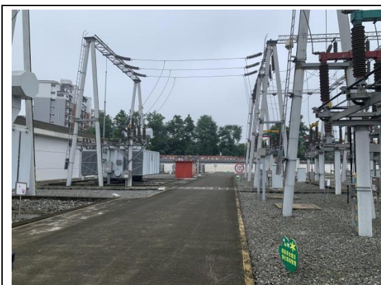
变电站站内布置
