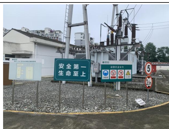
变电站站内布置
