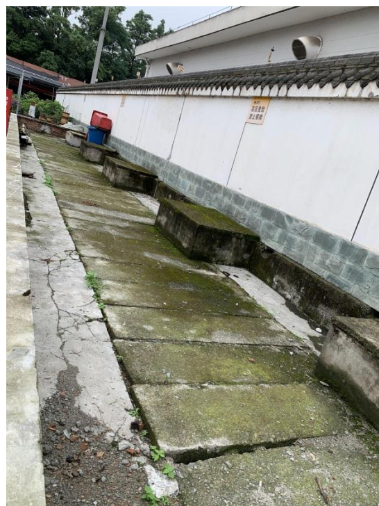
变电站地下排水管网
