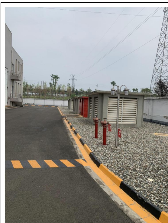
变电站内情况
