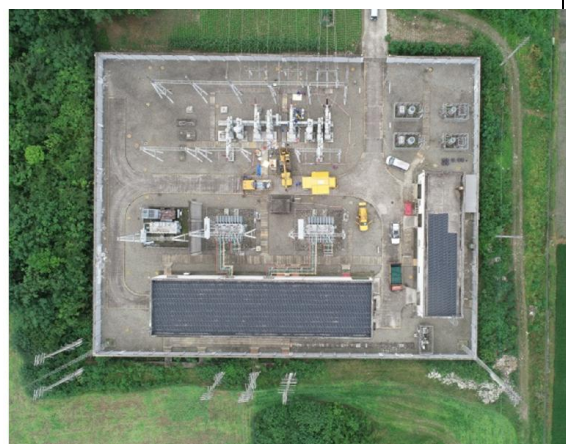
安仁 110kV 变电站情况
