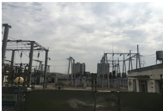
何店 110kV 变电站
