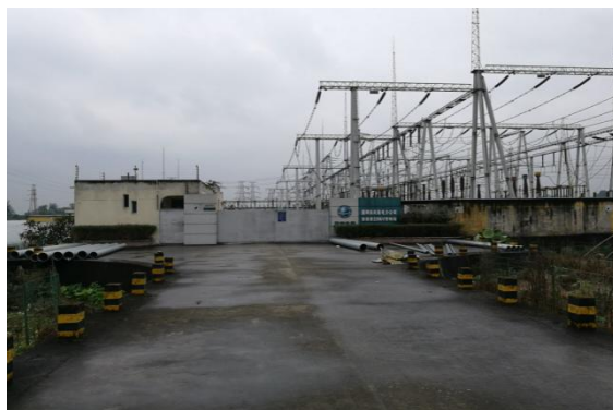
徐家渡变电站现状
