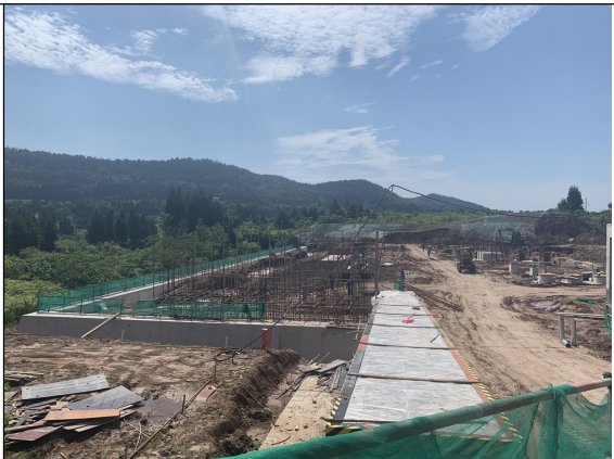
变电站站外挡土墙、进站道路挡土墙
