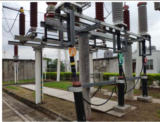
图 1 原林茜北线间隔改为入地电缆
