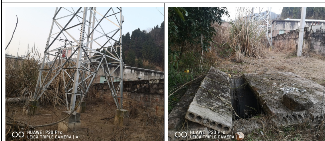
螺广线 \pi 入玉台站 35 千伏线路工程（电缆）起点 N9#塔和已建电缆井
