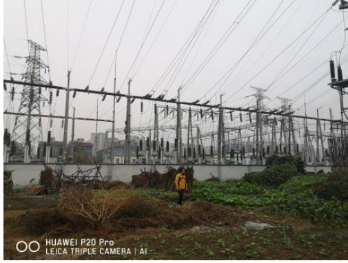
大丰站出线间隔
