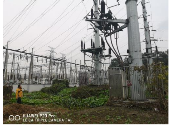
架空线路（仅 1 基钢管塔）
