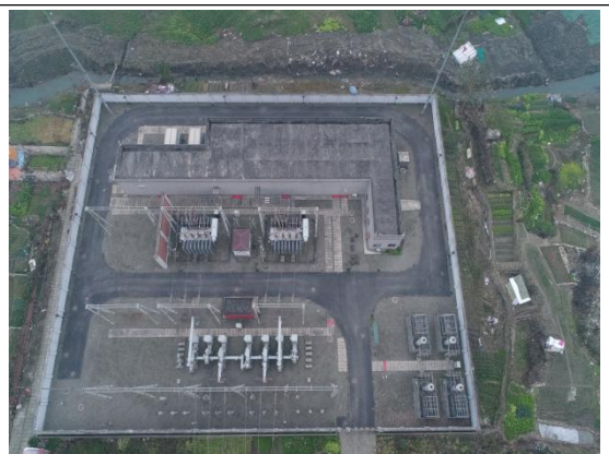
变电站全景图
