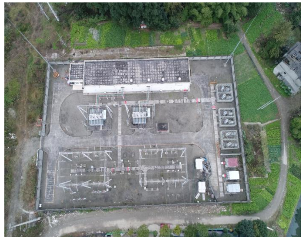
变电站全景图
