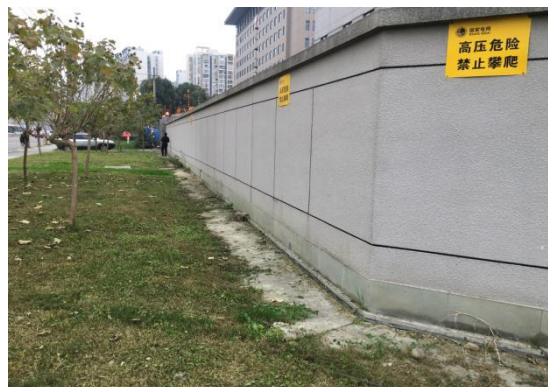
站外盖板排水沟及撒草绿化
