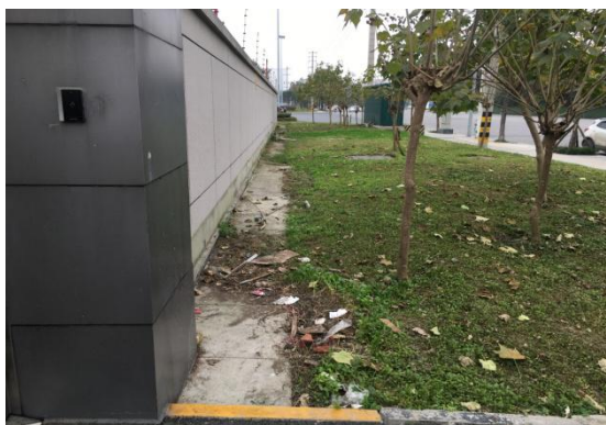
站外盖板排水沟及撒草绿化
