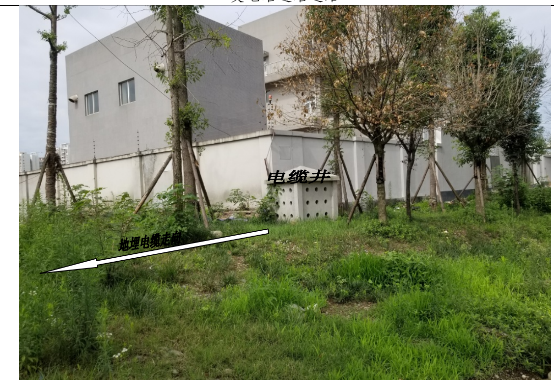
地埋电缆通道
