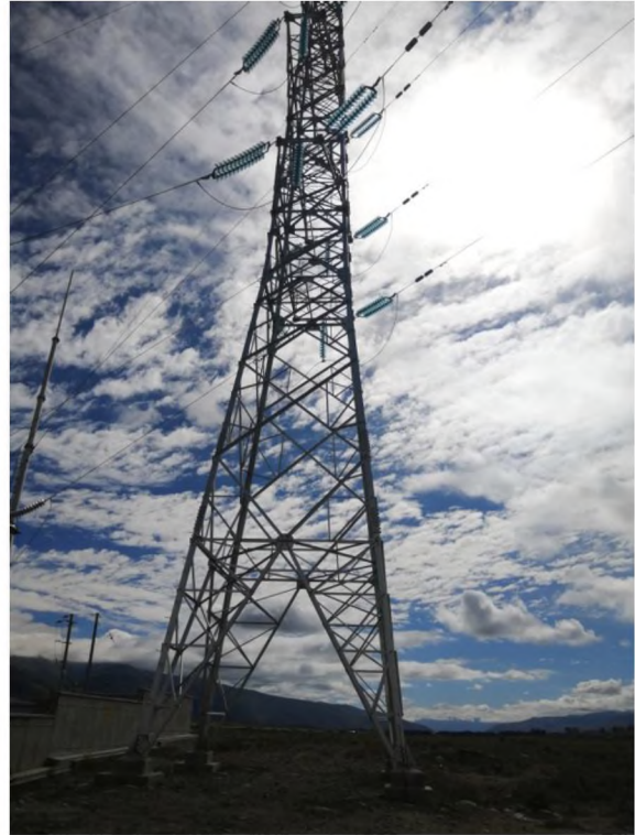
双回路段来石线 1#（甘来线 100#）塔
