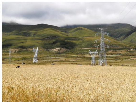
工程输电线路 \pi 接处
