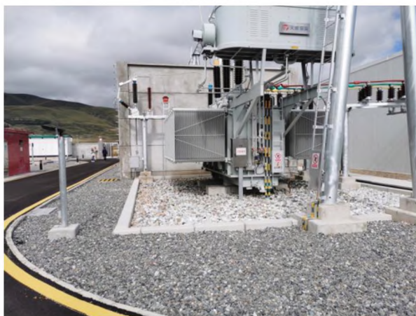
110kV 主变压器
