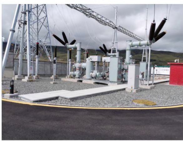
110kV 配电装置
