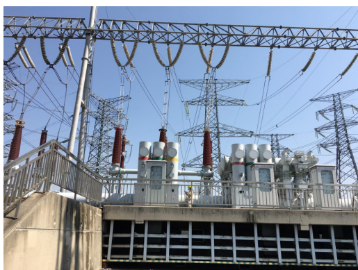
本次 220kV 扩建间隔
