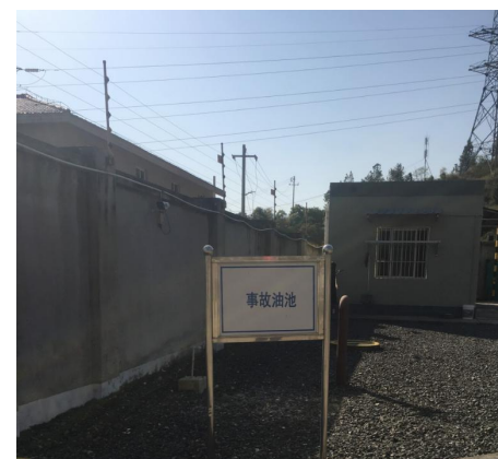
岩神山变电站事故油池
