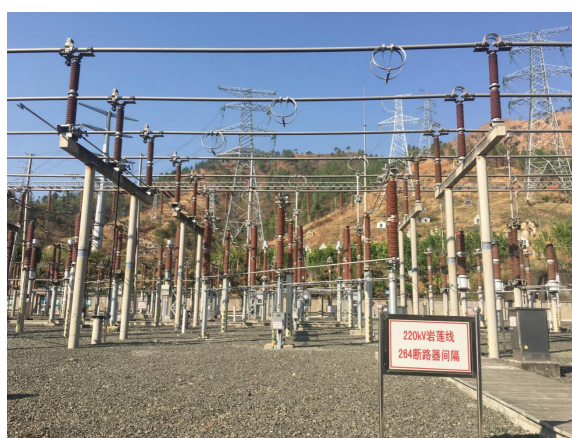
本次间隔扩建间隔
