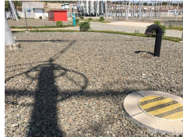
甘泉变电站事故油池
