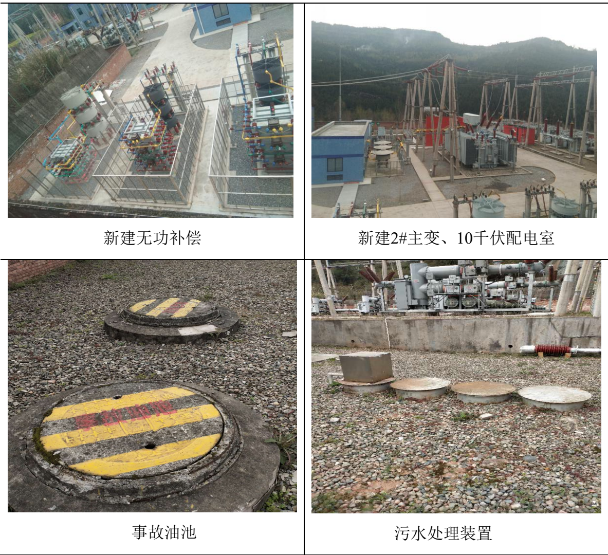
图4-2 草池220千伏变电站站内设施设备图
