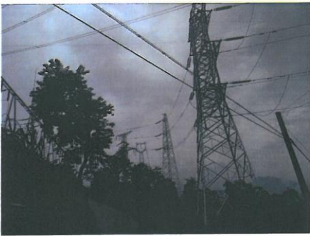
27#纳东 II 线震东 220kV 变电站出线间隔线下
