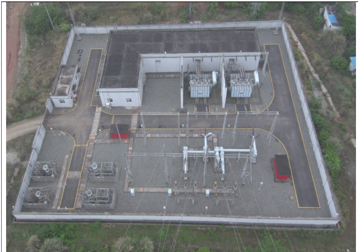
前进 110kV 变电站航拍全景
