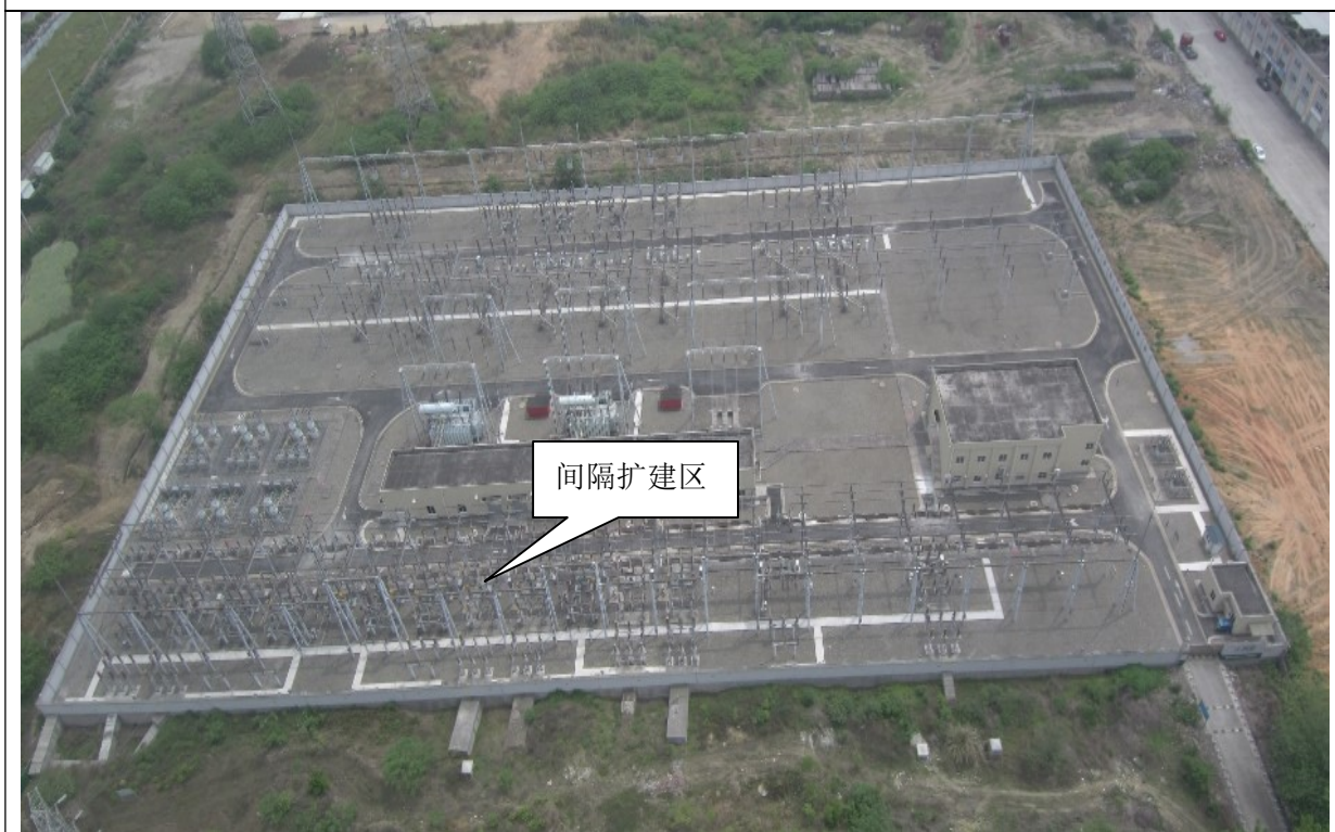
大同 220kV 变电站航拍全景间隔扩建工程
