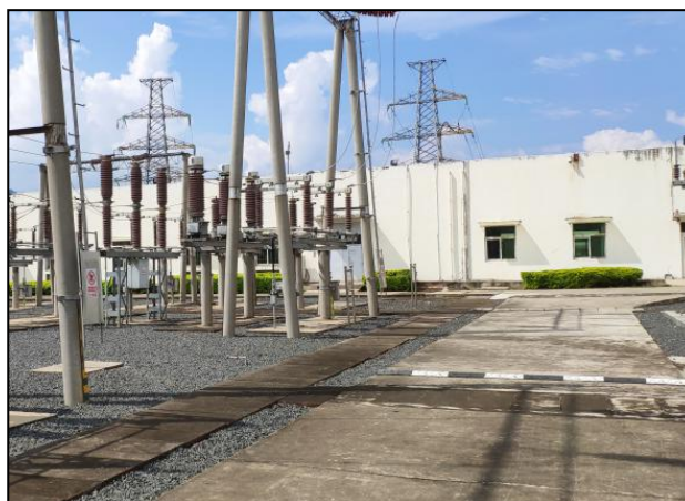
图 8-3 本项目变电站内地面硬化情况
