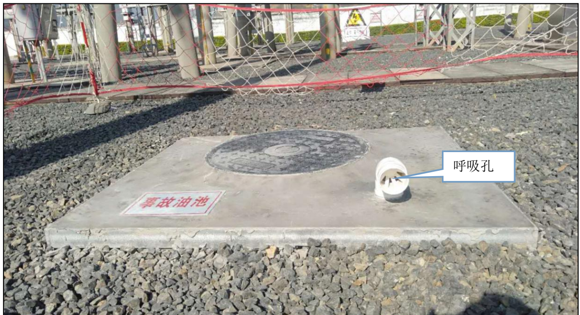
图 8-4 本项目变电站事故油池
