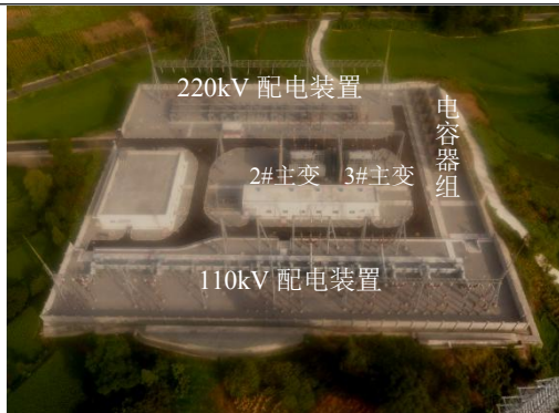
图 1 大竹变电站全貌
