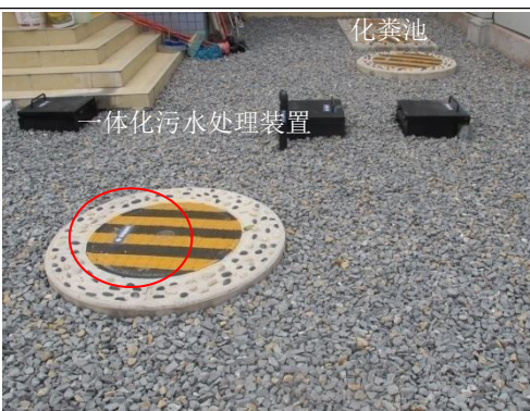
图 4 化粪池及地埋式污水处理设施
