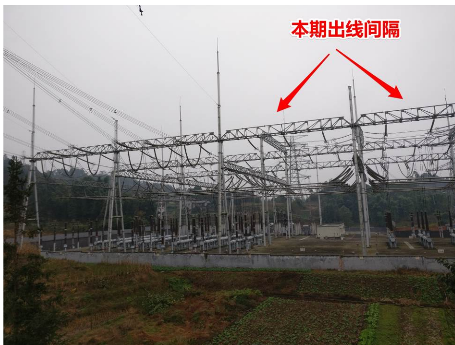
图 3-1 沐溪 500kV 变本期出线间隔现场照片
