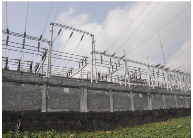
变电站间隔现场照片
